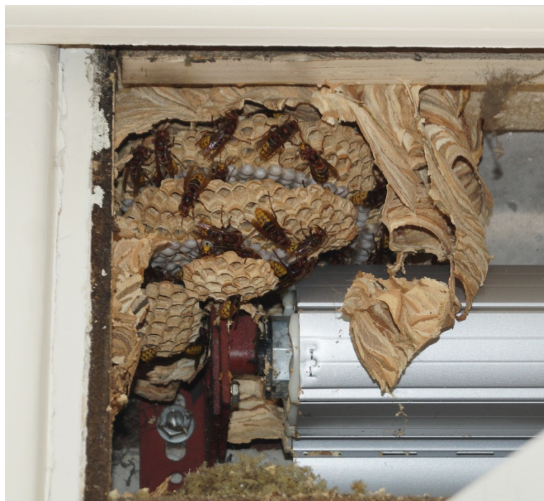
Der Servicedeckel des Rollladens ist offen und der Blick zum Hornissennest frei
