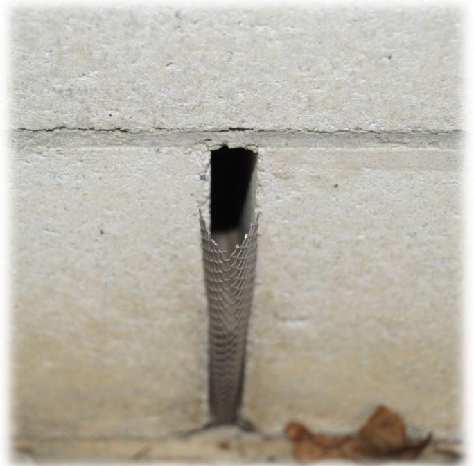
Hinterlüftung mit einem feinmaschigen Edelstahlgitter vor einer erneuten Besiedelung schützen!
